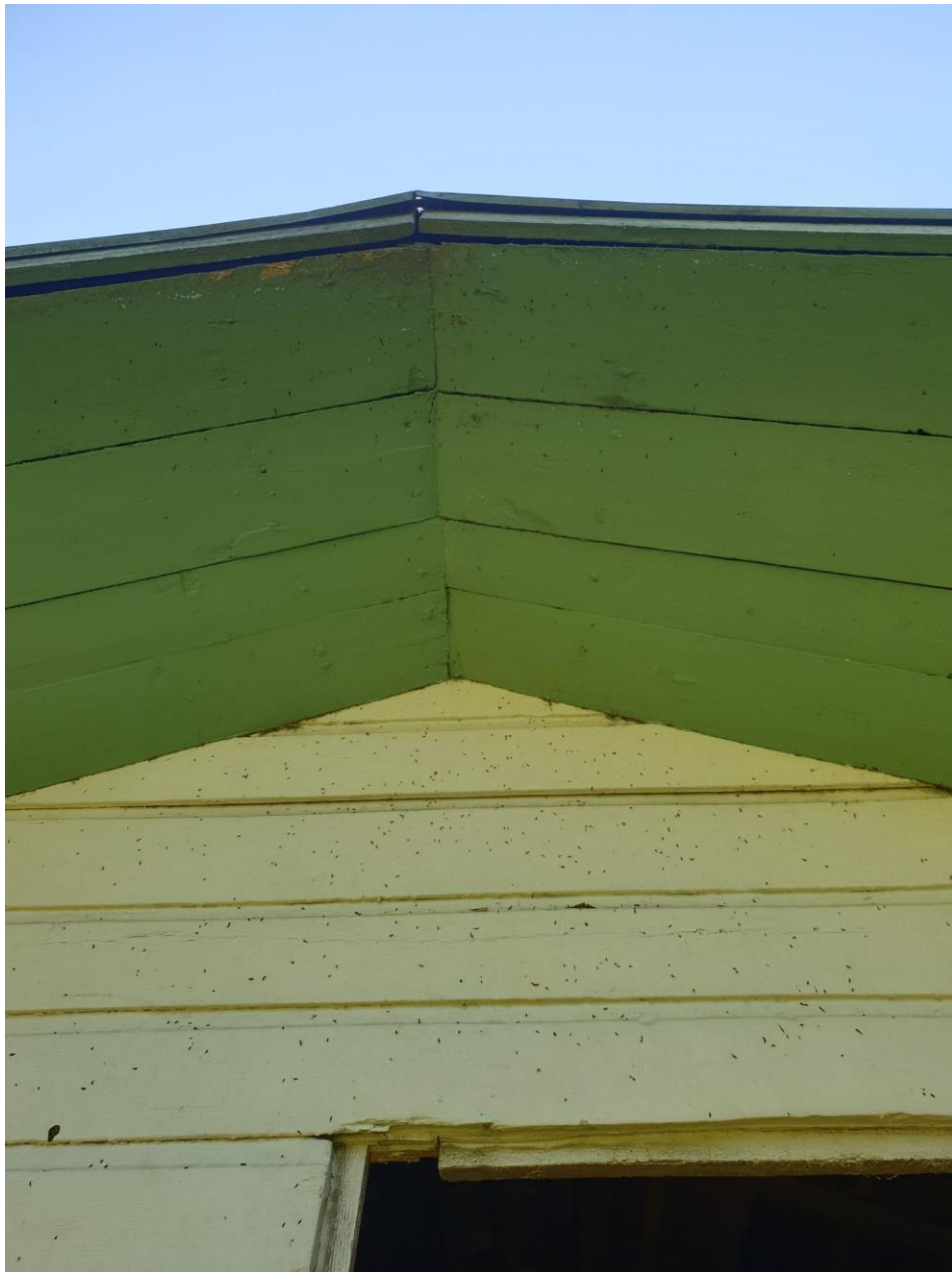
Kuva 9. Lepakoiden käyttämässä rakennuksessa voi ulosteita näkyä myös ulkoseinillä, varsinkin kulkuaukon läheisyydessä. Kuvan rakennuksessa asuu isoviiksisipiipahdyskunta, jonka kulkuaukko on räystäään päädystä (Ville Vasko).
